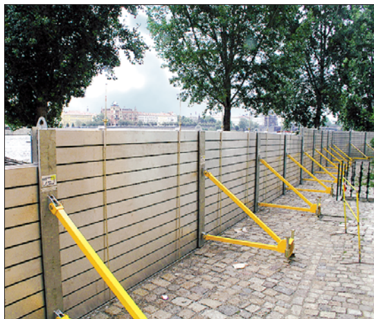
Před škodami na majetku během povodní chrání také protipovodňové bariéry. Jejich budování je však velmi nákladné.
