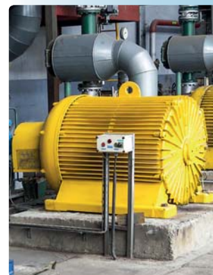
Průmyslový motor pohánějící čerpadlo
